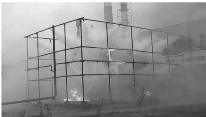
Рис. 4. Выпуск \text{CO}_2 на защищаемый трансформатор
